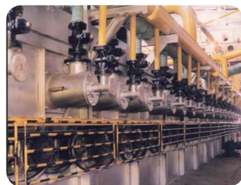
天然气烧嘴 Natural gas burners
