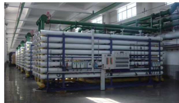
▲ 中水深度处理站
