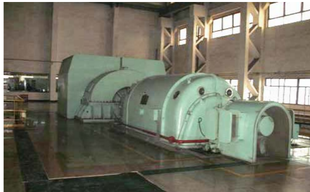
▲ 6MW低压饱和蒸汽发电
