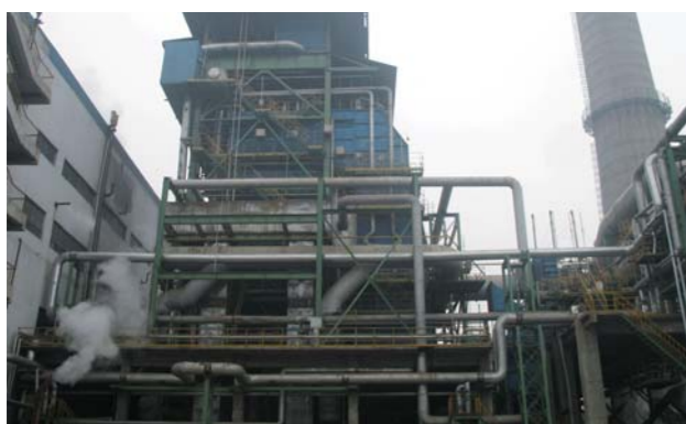
▲ 25MW自备电站
