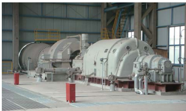
▲ 30MW高炉煤气余压发电（TRT）
